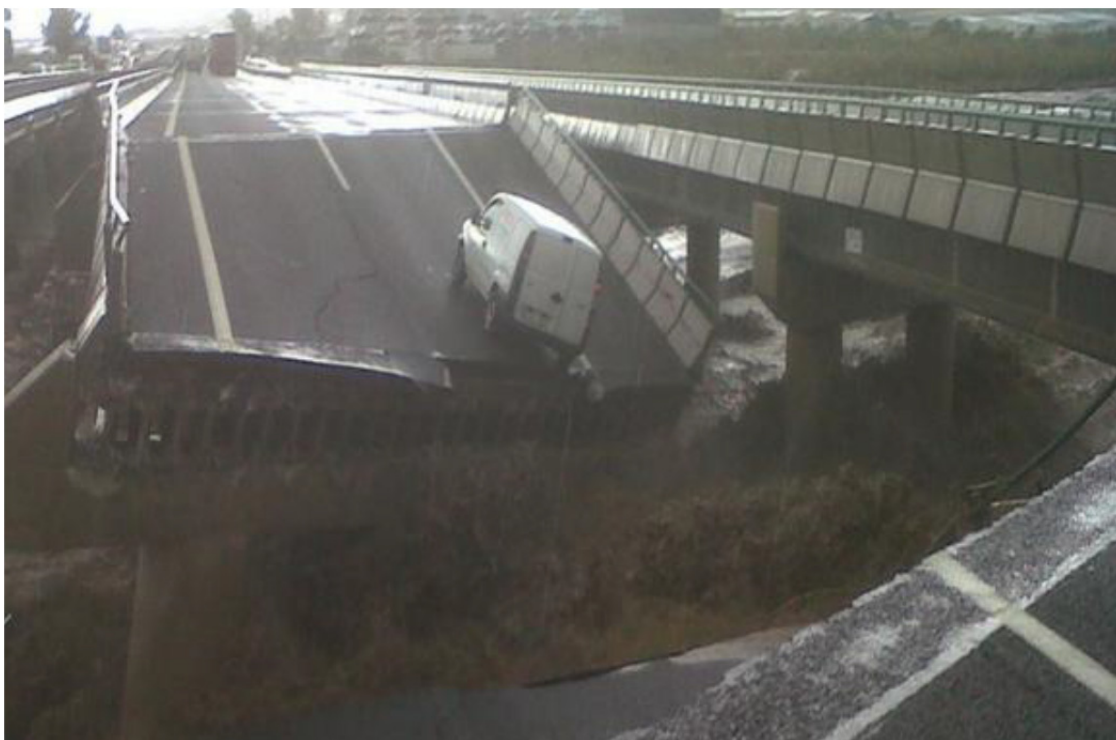
Fig. 1: Puente arrasada entre Lorca y Puerto Lumbreras (Murcia) en septiembre de 2012 a causa de las precipitaciones
