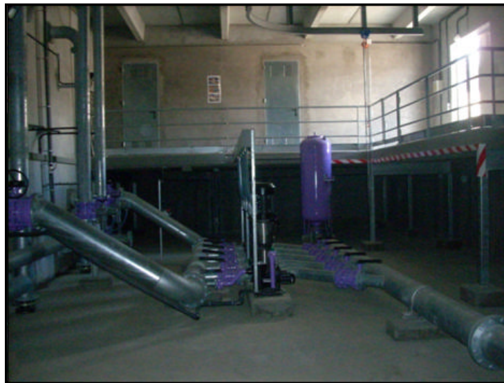
Figura 3. Interior de cámara de válvulas de depósito de agua regenerada.
