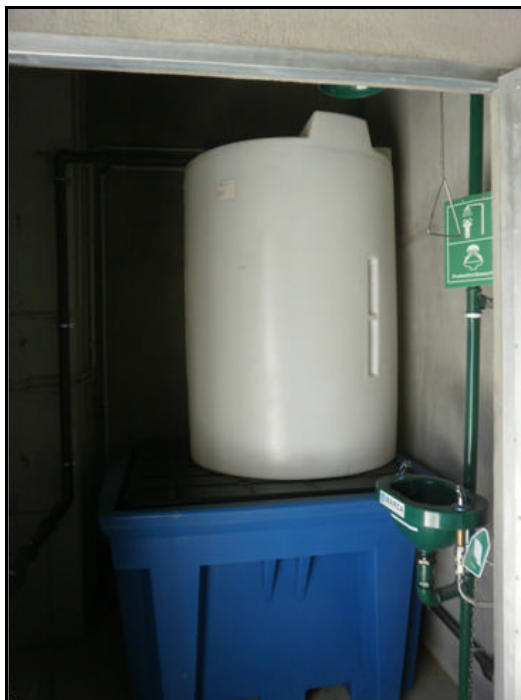
Figura 4. Interior de sala de cloración.
