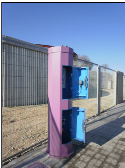
Figura 5. Toma de agua regenerada para baldeo.
